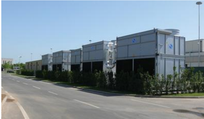
Torres refrigeración Baltimore
