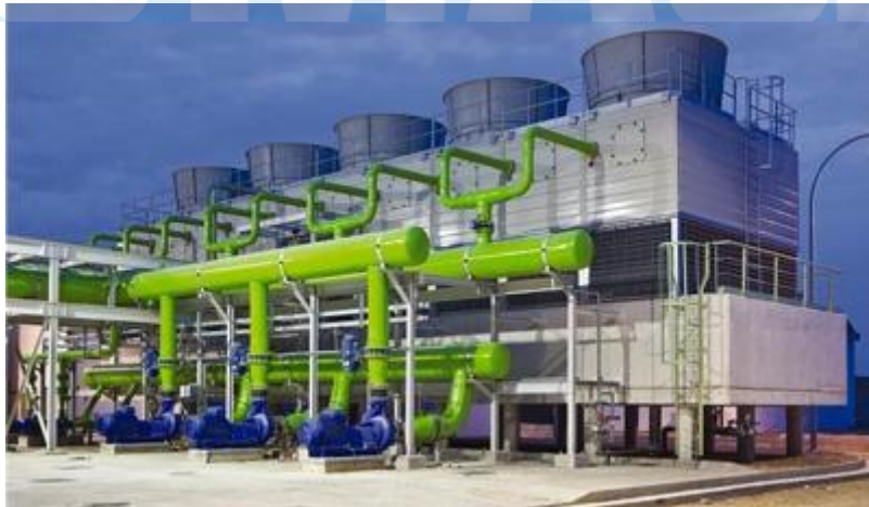
Torres de Refrigeración Teva
