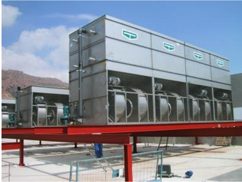
Torres refrigeración Evapco
